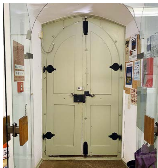
Undichte Eingangstür im Brüder Grimm-Haus und Museum Steinau, Steinau an der Straße
